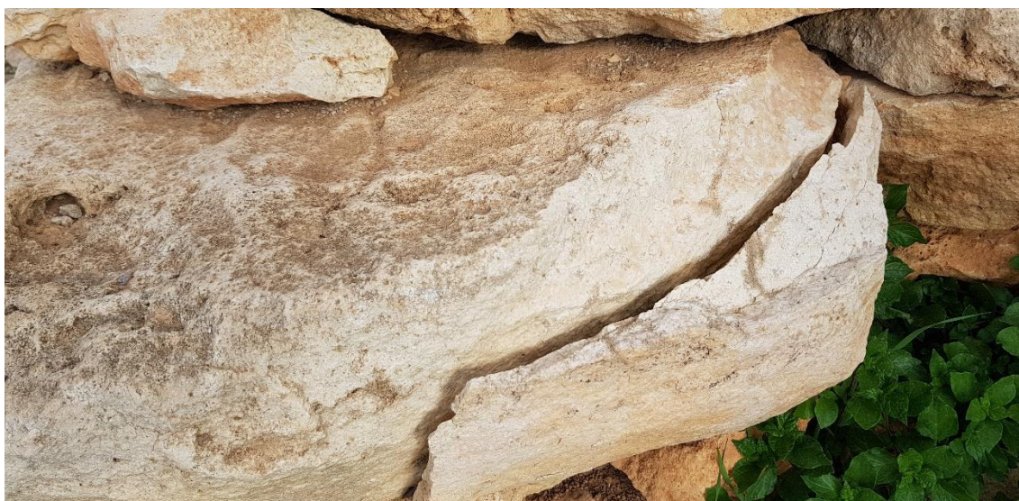
Exemples de fractures que poden afectar l'estabilitat Imatges: Kultura.
